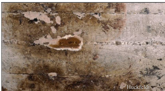
Abb. 8: Fruchtkörper des Echten Hausschwammes an einer Betondecke, über der befallenes Holz lag. Die Decke wurde von Mycel durchwachsen.
